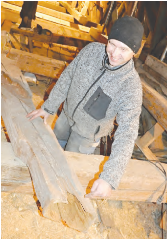
Tesař Ladislav Kučera ukazuje trámy poškozené dřevomorkou
